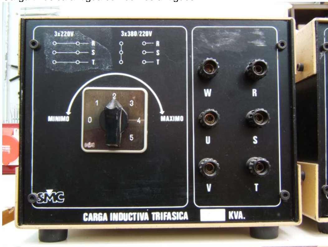
Carga trifásica antigua con bornes antiguos
