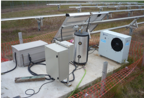
Figura 9. Instalación de ensayo de paneles PVT
